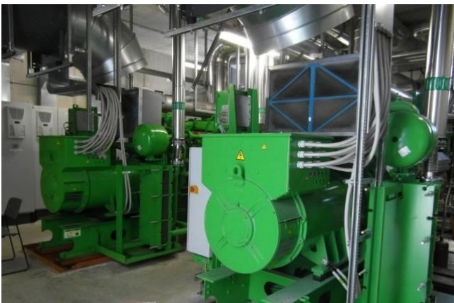
Figura 9 Gruppi di cogenerazione
