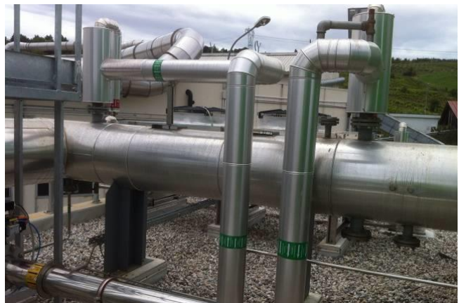
Figura 10 Sistema recupero calore dai fumi
