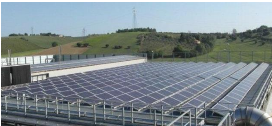
Figura 18 Impianto fotovoltaico sulla copertura dell'edificio di miscelazione e raffinazione
